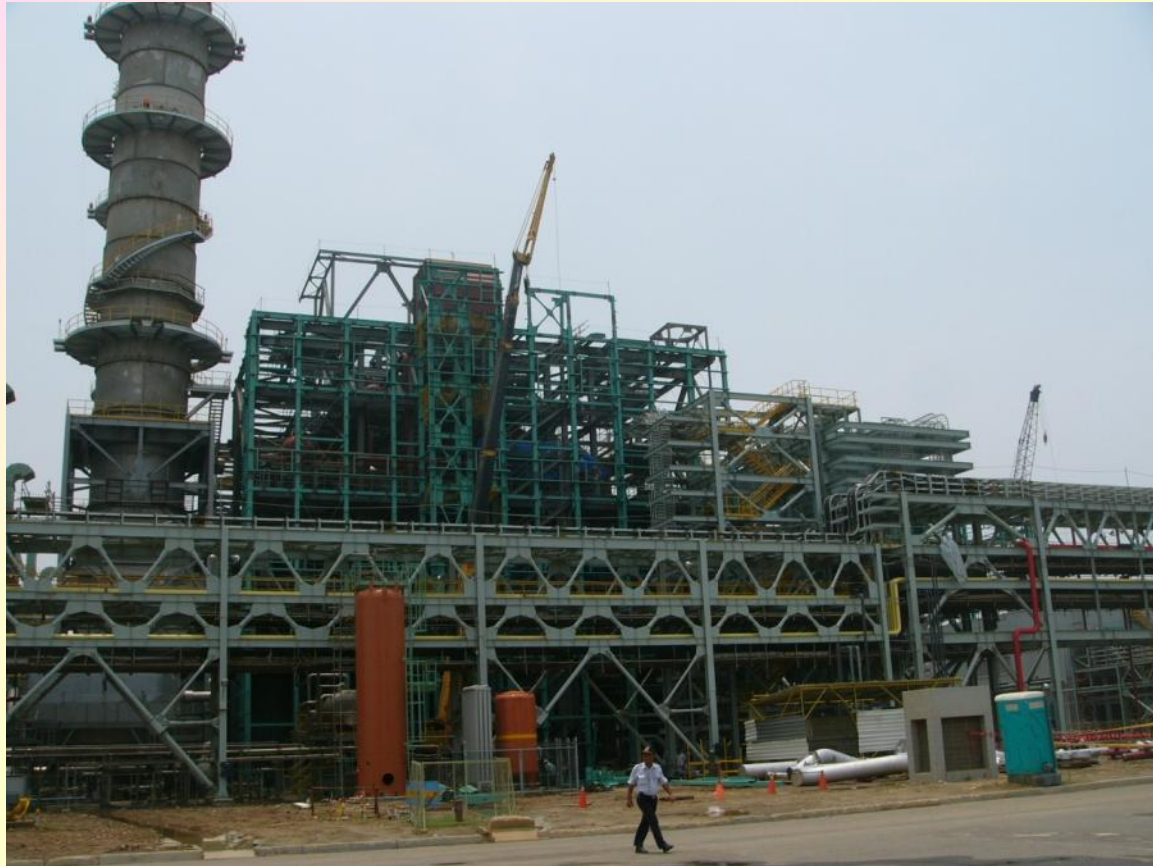
桃園大潭天然氣火力發電廠
